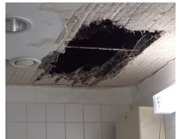
Plafond amianté, Image issue de la thèse de Richard Hees, The Beauty of Contaminant Renovations
